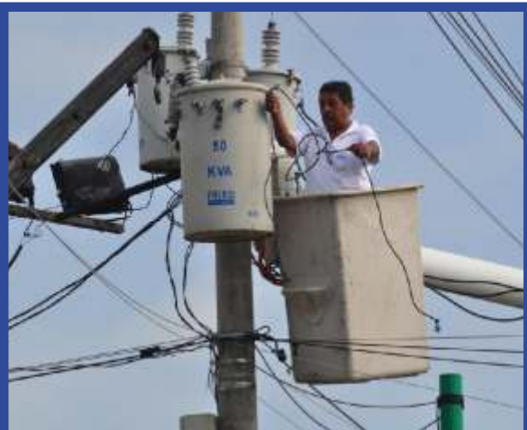
Realizar trabajos sin equipos de seguridad
